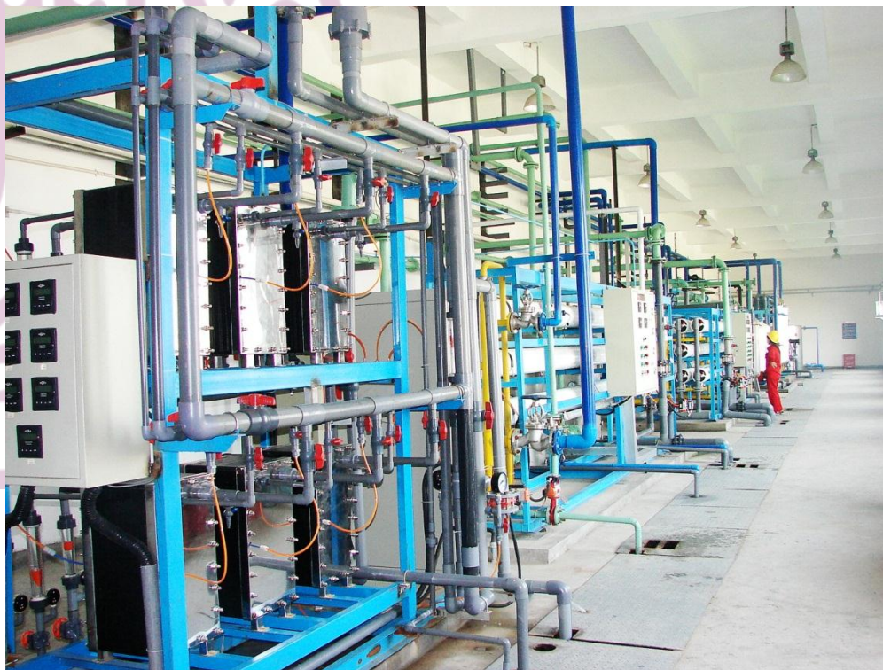
图 1：某天然气发电厂锅炉补给水示范工程（20 吨/小时）
